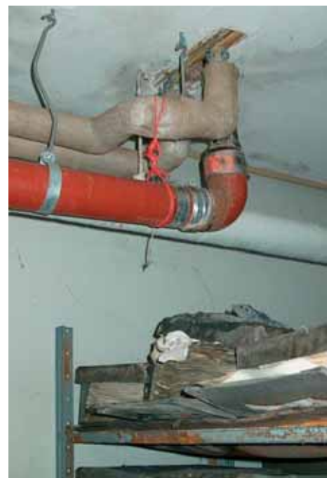
Vand fra utætte rør kan gøre stor skade på arkivalier og hører ikke hjemme i et arkivlokale.
